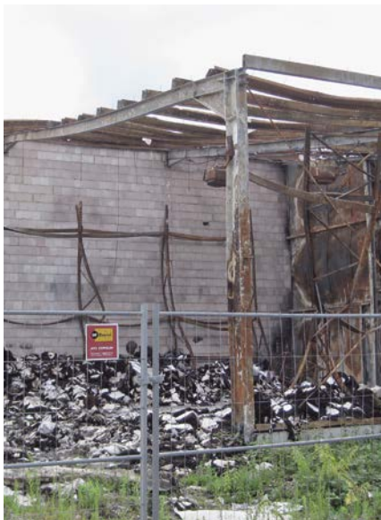
Bild 10 Durch Brand verformte Stahlkonstruktion vor unversehrter Kalksandsteinwand
